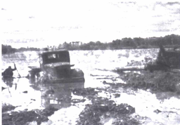
Прокладка нефтепровода Усть – Балык – Омск в районе Сингапая. 1965 г. Автор – Анатолий Мясников, из архива Сургутского краеведческого музея
